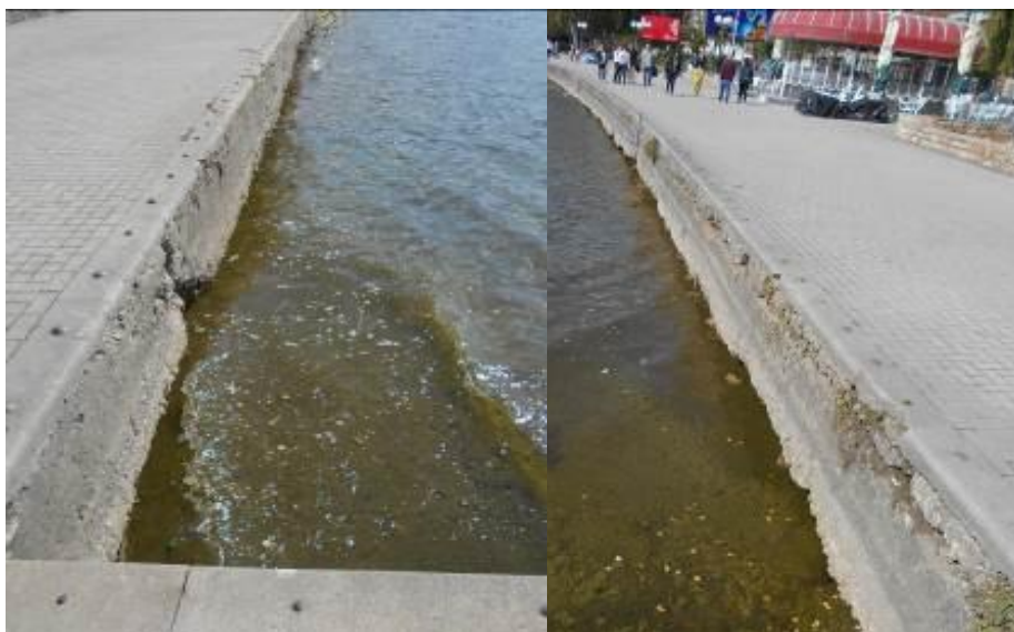
Слика 5 Оштетен потпорен сид
